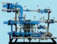
Установка индивидуальных тепловых пунктов
