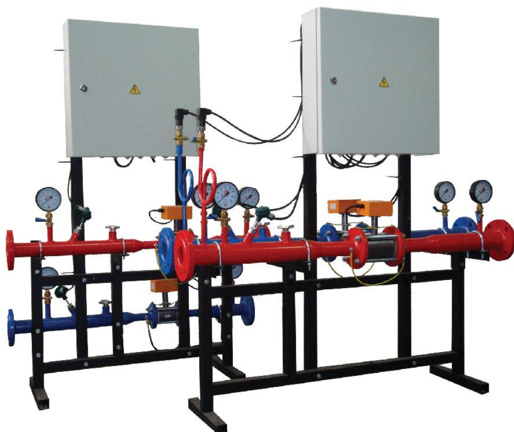
Рис. 2 Внешний вид узла учета тепловой энергии
